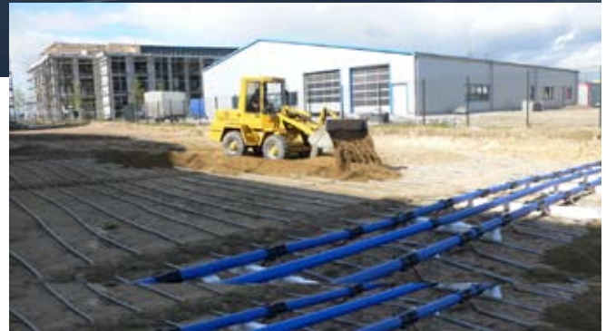
Parkplatz mit Erdkollektoren
